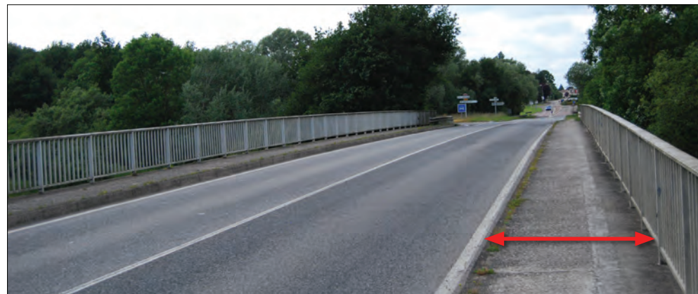
Un trottoir étroit et inconfortable pour franchir la rN12
