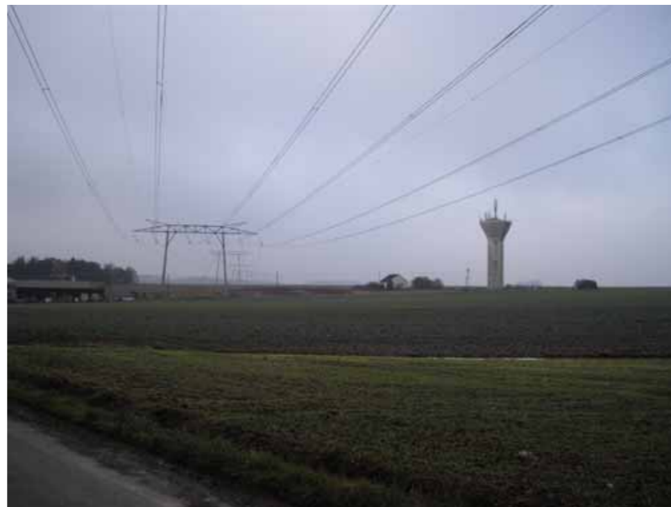
Réseau électrique au voisinage de Saint-Robert
