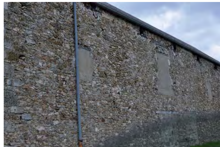
Exemple de bâtiment ancien présentant de nombreux interstices © A. de Montjoye – O.G.E.
