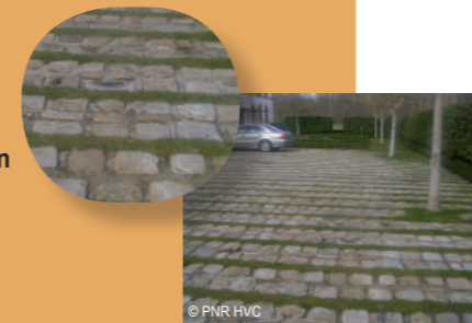
Une ligne d'herbe en alternance avec deux lignes de pavés qui permet l'infiltration des eaux de pluie et crée une élégante esthétique.
