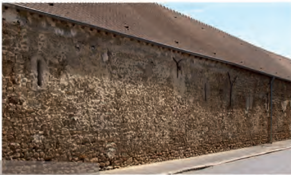
Les moellons de meulière, pierre rousse, sont aujourd'hui affleurants, mais les murs étaient antérieurement enduits, Grande ferme, Janvry
